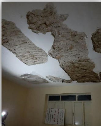
تصویر سه: خرابی سقف درمانگاه منطقه توتان
